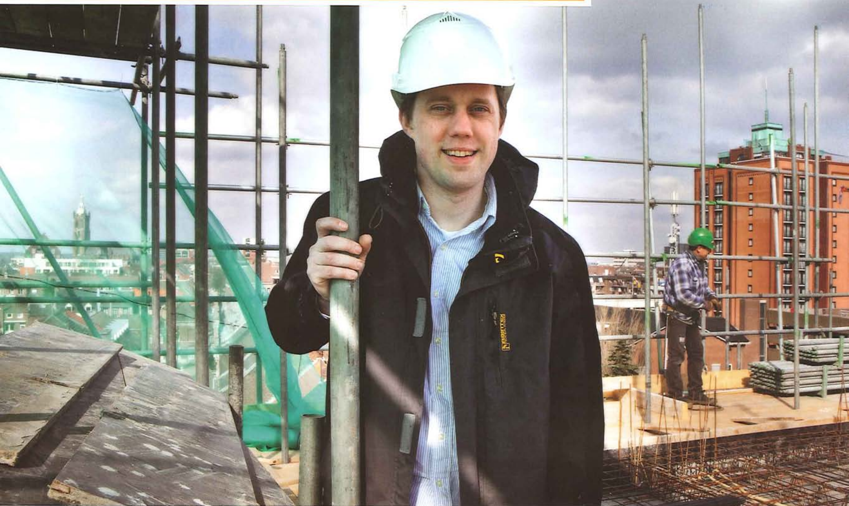
Rick Ursem geniet van het uitzicht vanaf het in aanbouw zijnde appartementencomplex "De Toerist".
